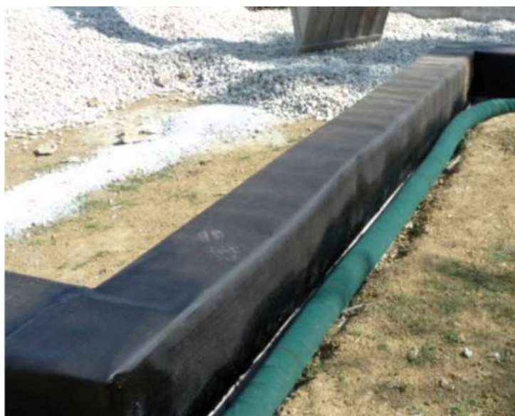
Eventuali infiltrazioni incontrerebbero la guaina tagliamuro e non potranno essere smaltite.
